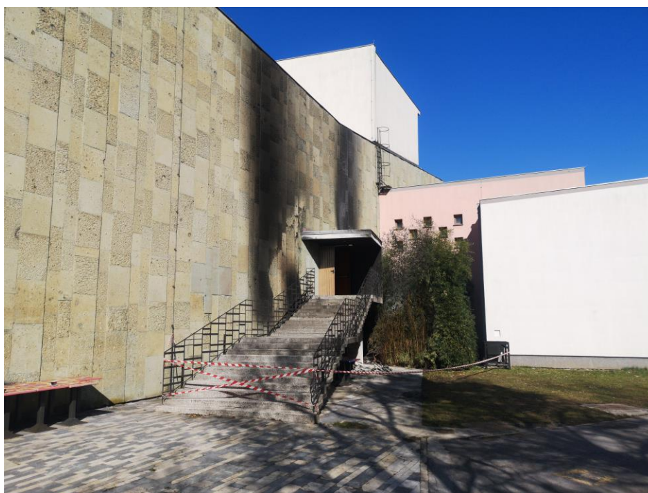
Izgled kulturnega doma po požaru
